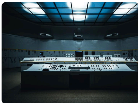
Unité d'automatisation du bâtiment
