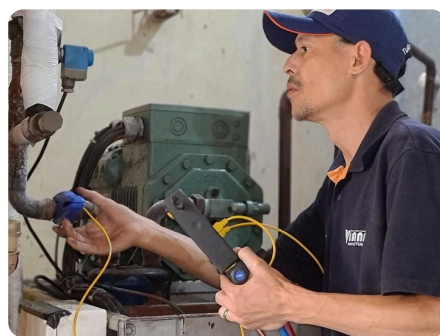
Compresseur frigorifique FROID INDUSTRIEL
