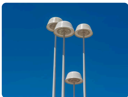
Luminaire d'éclairage public ÉCLAIRAGE
