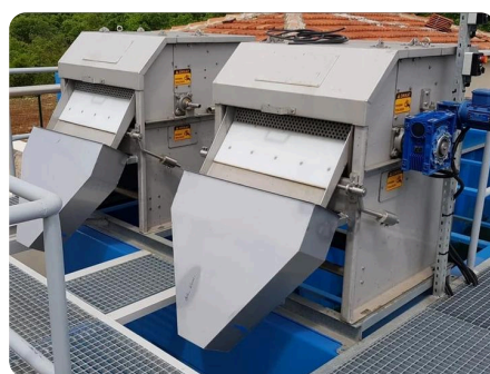
Équipement de traitement de l'eau
