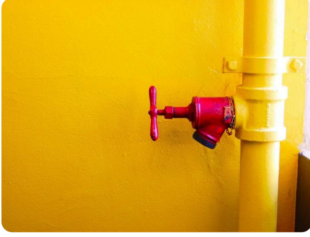
Tahliye vanası MEKANİK TESİSAT
