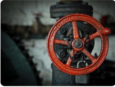
Kondenstop MEKANİK TESİSAT
